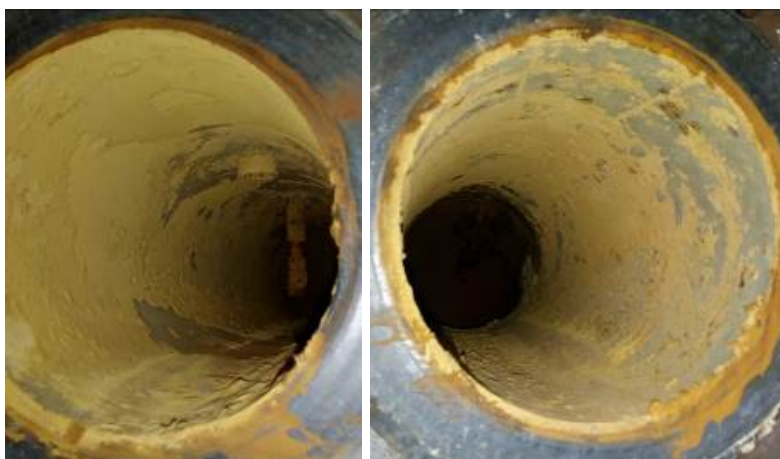
Рисунок 7.18 – Фото внутрішньої поверхні трубопроводу котельні “Макіївська”, вкритого шаром осаду продуктів корозії.
