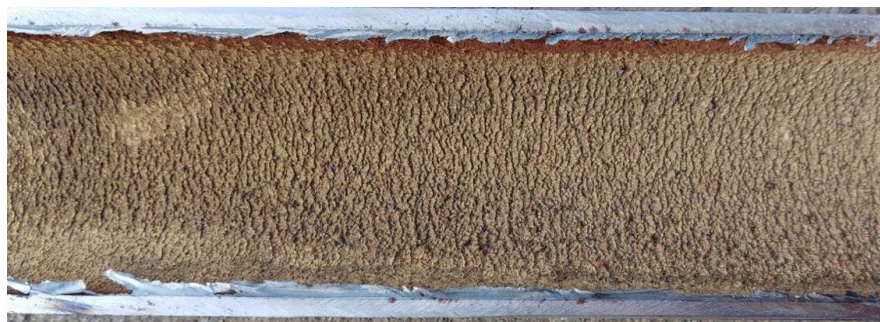
Рисунок 7.32 – Фото вирізки труби з котла після випробувань реагентної водопідготовки.
